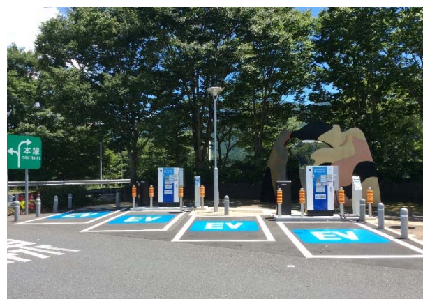
休憩施設に整備した EV 急速充電器
