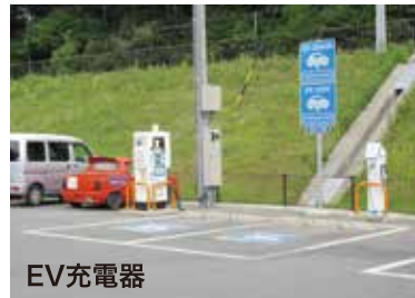
EV充電器 急速充電1台、普通充電1台を設置
