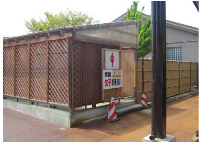
【特設トイレの設置】
