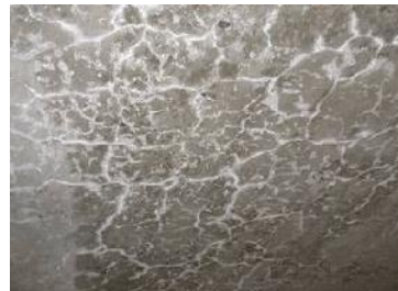
コンクリートのひび割れ
