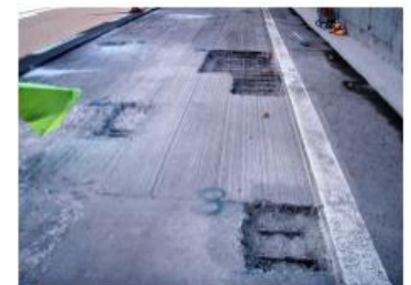
既設床版の劣化状況
