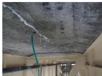
コンクリートのひび割れ
