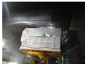
《トンネル坑口はく落対策》
